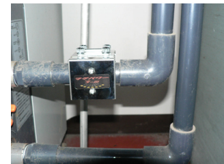
磁気活水器マグパワー取付状況
