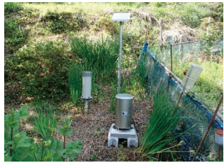
傾斜計/ソーラー/雨量計
