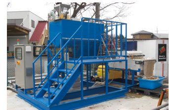
排水処理装置
