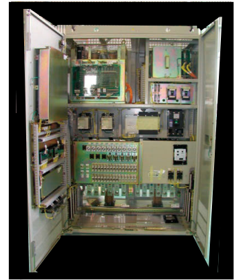
盤組立完成品
