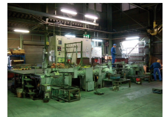
高周波溶解炉
