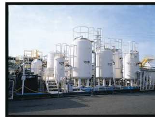
イオン交換による廃水処理設備
