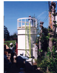
汚水処理装置1
