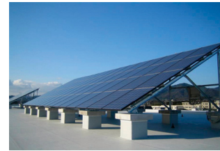
太陽光パネル
