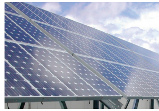
太陽光発電設備
